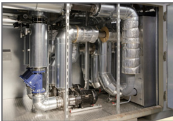
Mobile Technikcontainer und Übergabestationen
